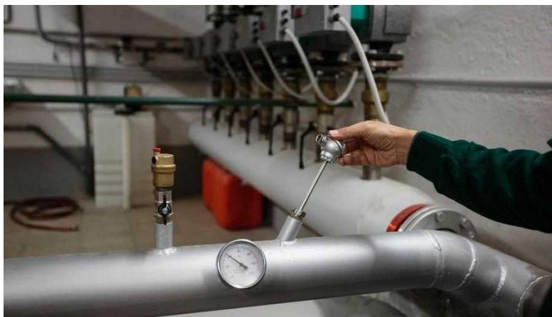
teleriscaldamento, le vecchie caldaie accanto al nuovo impianto (b. 67) Immagine 20102017-D175620.jpg da marbos host CUN5 @autore FANDOG
