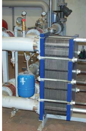
Scambiatore di calore
