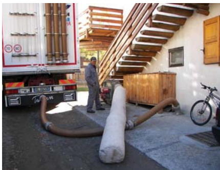
Conferimento del cippato con camion pompa
