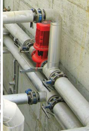
Elettropompa di circolazione
