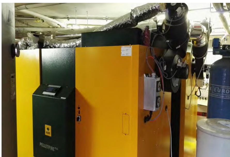
Una delle due caldaie KWB Pellet Fire da 115 kW
