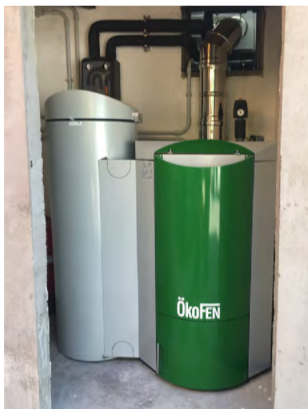
La caldaia a pellet
