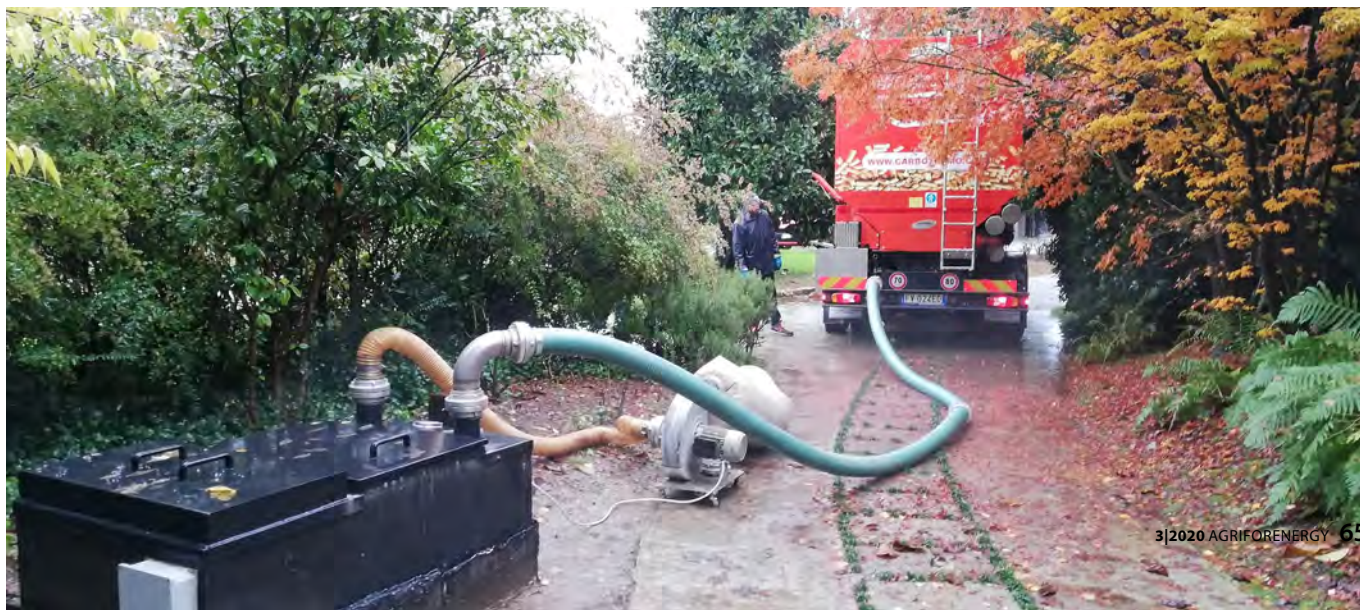
Lo sportello esterno del deposito del pellet con i bocchettoni a tenuta stagna durante il rifornimento
