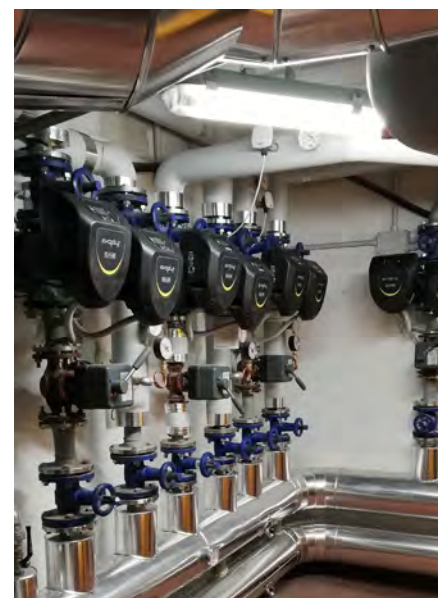
Un particolare dell'impianto di distribuzione
