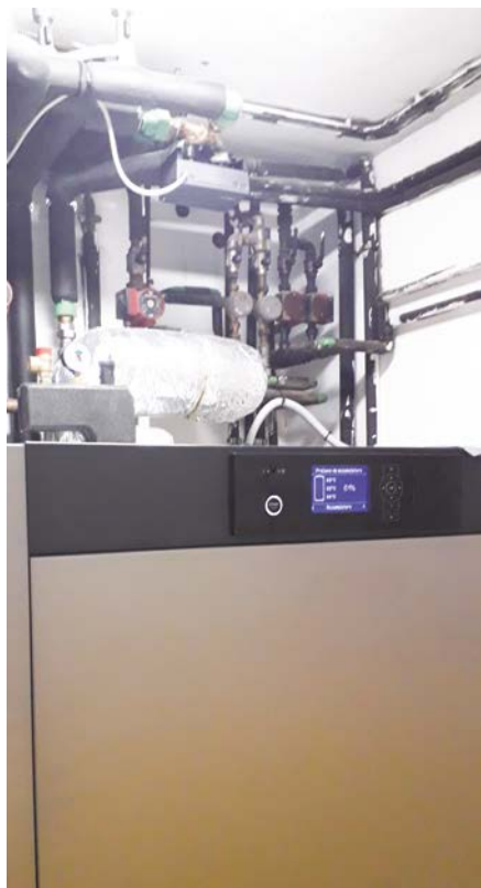
La nuova caldaia a pellet di 32 kW che garantisce un basso livello di emissioni e un rendimento del 95%
