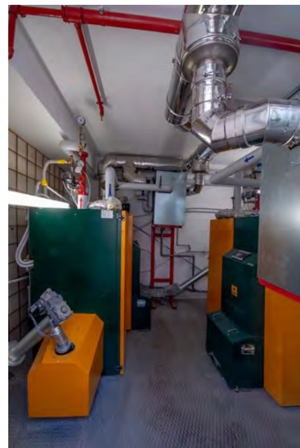
Le due caldaie a pellet a condensazione KWB installate da Carbotermo
