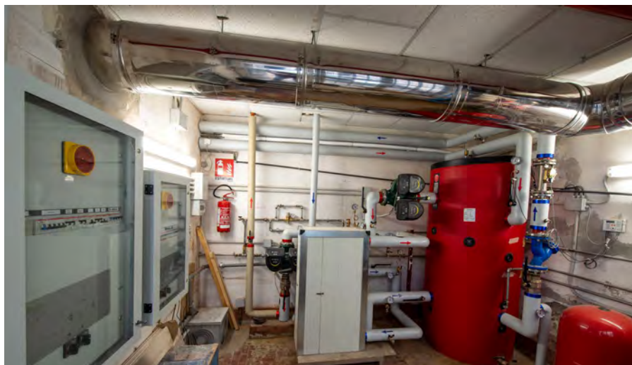
Il locale caldaia
