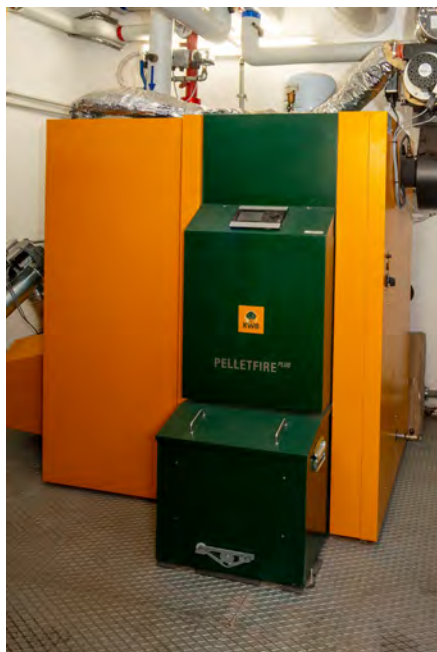
La caldaia KWB Pelletfire Plus da 100 kW installata da Carbotermo
