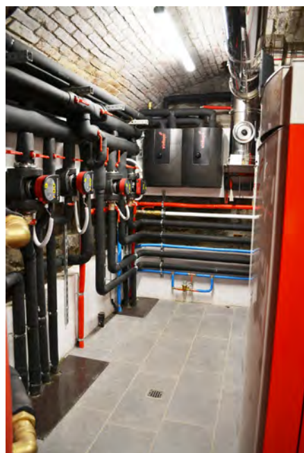
Particolari dell'impianto termico
