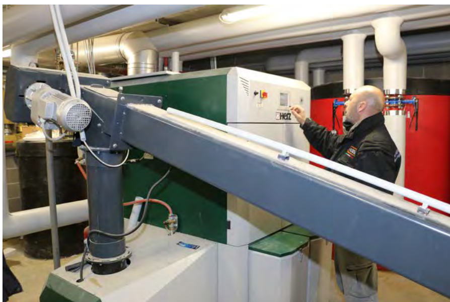
Un tecnico controlla il perfetto funzionamento dell'impianto
