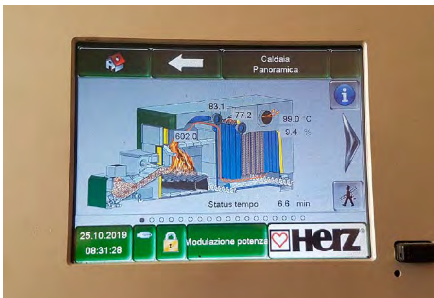
Il pannello di controllo
