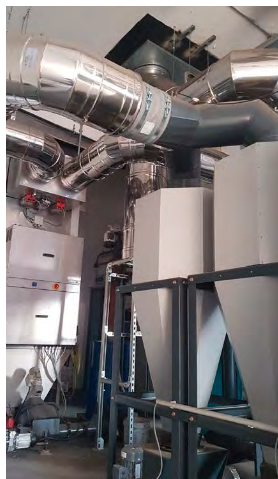
L'impianto di filtrazione
